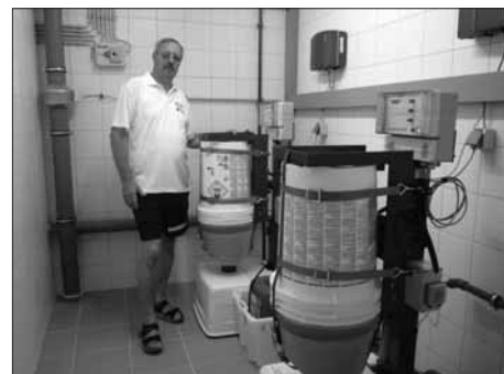
Bademeister Werner Stefan vor der neuen Chlordosieranlage im eigens dafür errichteten Anlagenraum.
